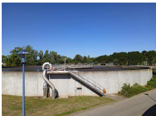
Station d'épuration de Lorient KEROLAY
